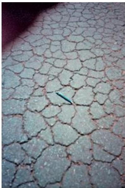
Figura 14 - Exemplo de trincas couro de jacaré
