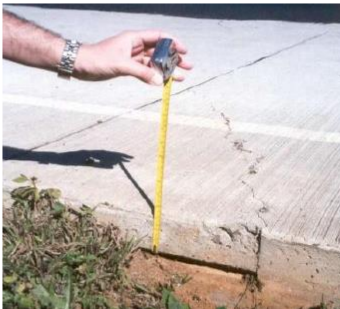
Figura 17 - Exemplo de uma fissura de canto
