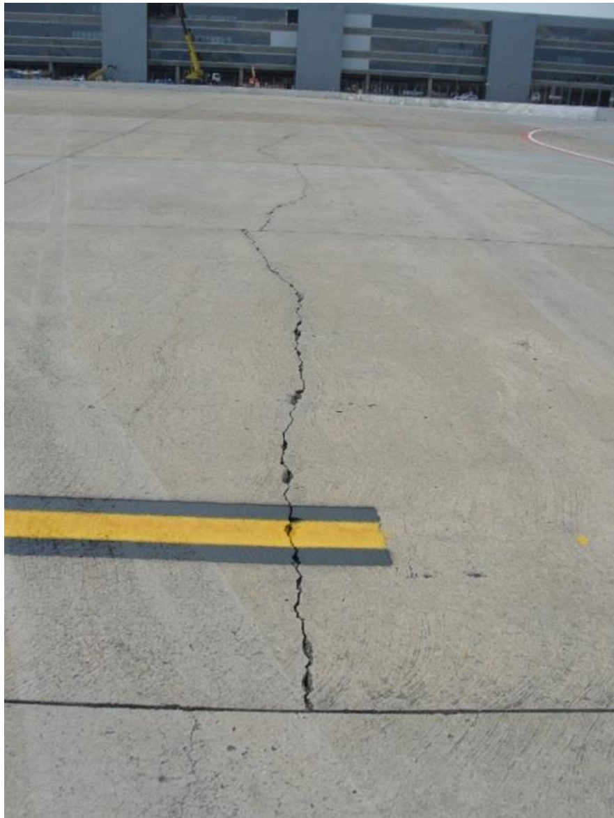
Figura 15 - Exemplo de fissura transversal
