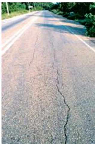
Figura 13 - Exemplo de trinca longitudinal longa
