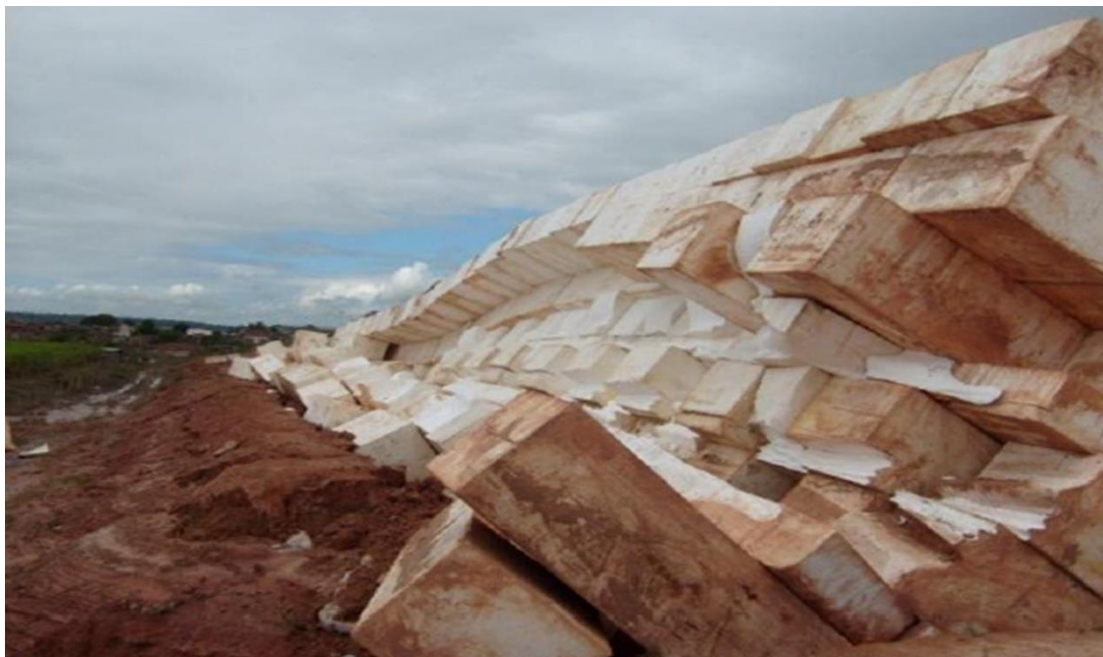
Figura 38 - Ruptura de aterro na duplicação da BR 101 em Pernambuco por flutuação durante alagamento
